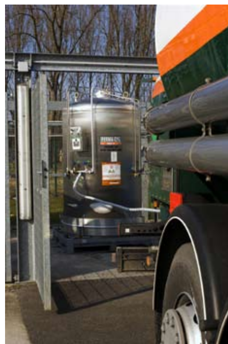
Kryogenní nádrž, která je pravidelně doplňována malým cisternovým vozidlem.
